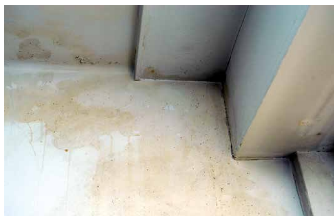
Bruine vlekken als gevolg van lekkage.
