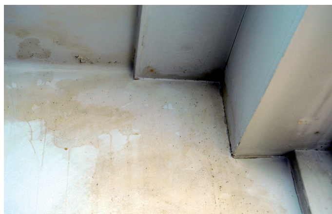
Bruine vlekken als gevolg van lekkage.
