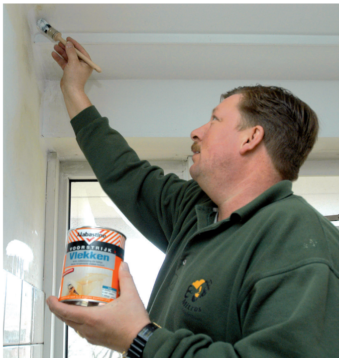
Isolatieverf bedekt de bruine vlekken.
